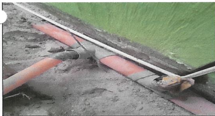
Foto 5: DRENAJES Y AGUA POTABLE
